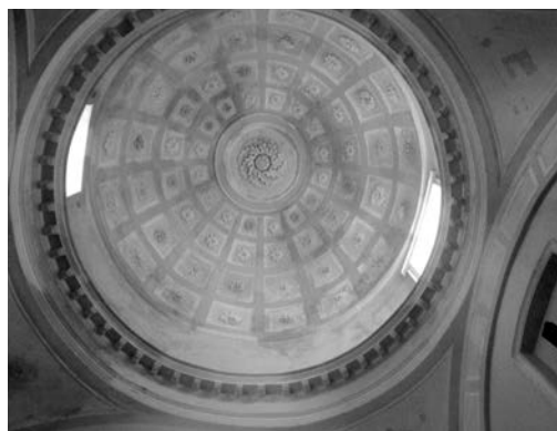
Dall'alto: Laurino (Salerno). La tribuna rinascimentale della chiesa dell'Annunziata (foto E. Lanzara, 2017); Sant'Andrea di Conza (Avellino). Intradosso della cupola cassettonata della chiesa cinquecentesca di San Michele, restaurata a seguito del sisma del 1694
